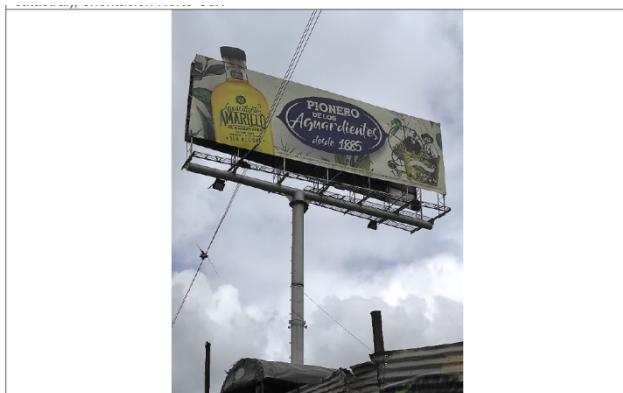
Foto 2. Vista del panel orientación Norte - Sur y de la estructura de la valla, en buenas condiciones y estable.
